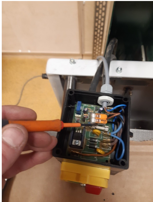
(Bild nr. 11) Montera WAGO 2:an
